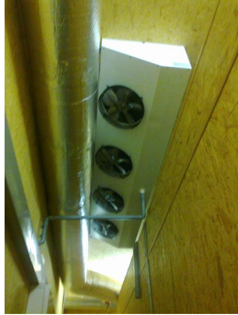
Figure 10 : Unité intérieure du système de réfrigération
