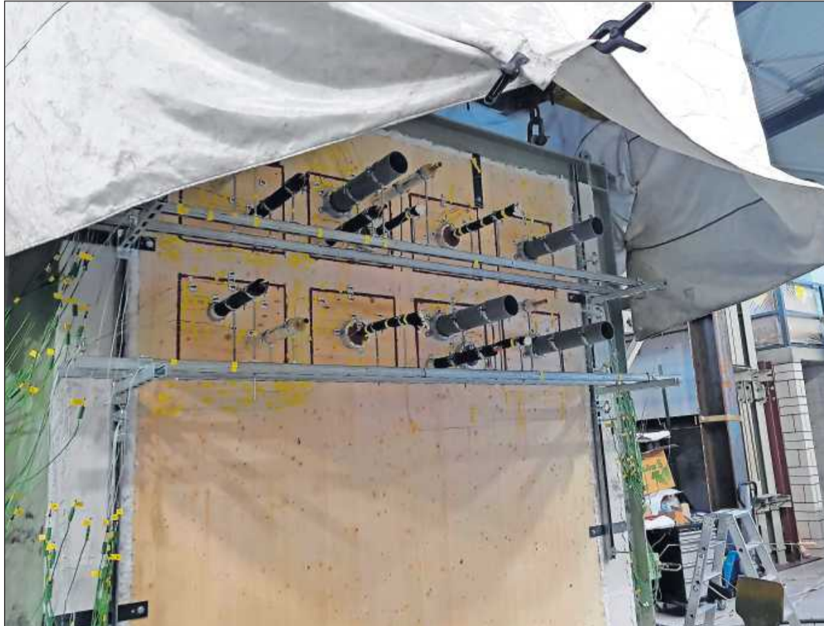
So sieht die Holzwand mit den durchgeführten Rohren von außen aus. Hinter der Holzwand sind die Brenner des Brandofens.
