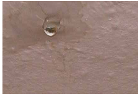
Abb. 3: Wassertropfen aus Deckenlampenloch für die Kabelführung
